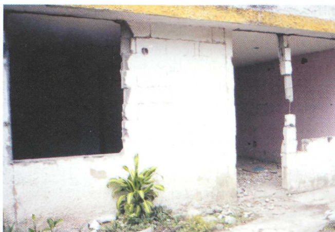
Vivienda en la zona 13, colapsada por el sismo
