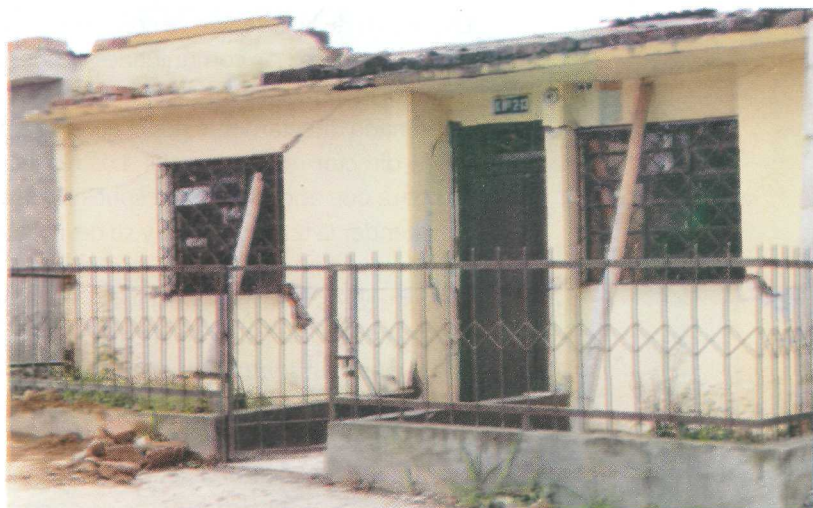
Vivienda colapsada en el barrio El Placer
